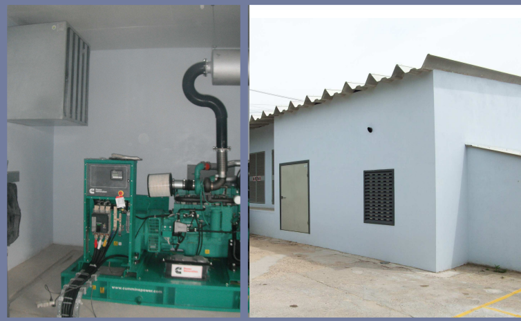
Subestação PA Lomba do Pinheiro
