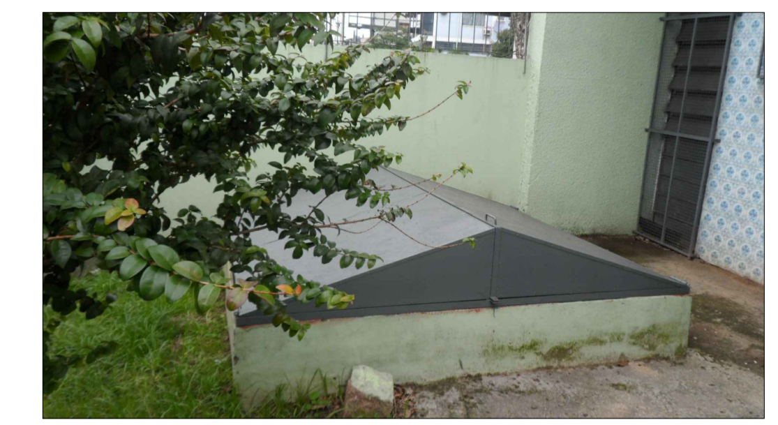
FOTO 2 – VISTA CÂMARA DE MANOBRAS
