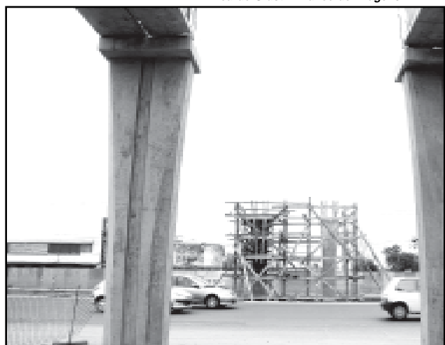
Obras de infra-estrutura como o Viaduto Leonel Brizola atraem investimentos privados para a região
