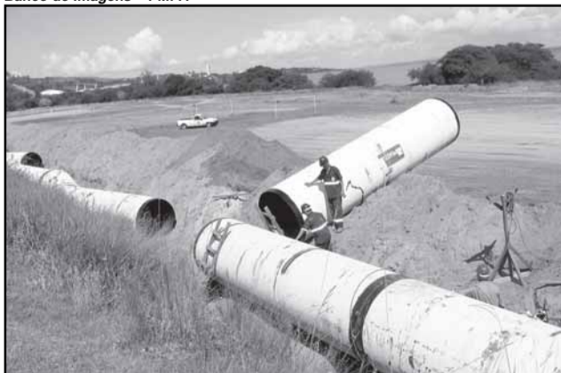
Tubos de aço serão ligados à Estação de Bombeamento de Esgotos Cristal
