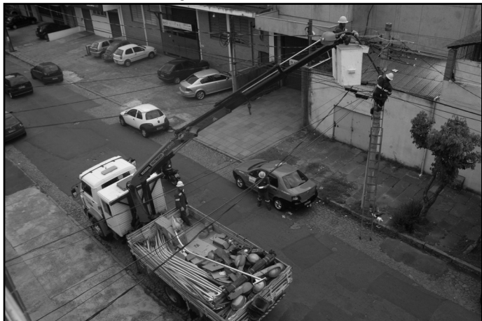
Documento relaciona os 54 mil pontos de iluminação já substituídos
