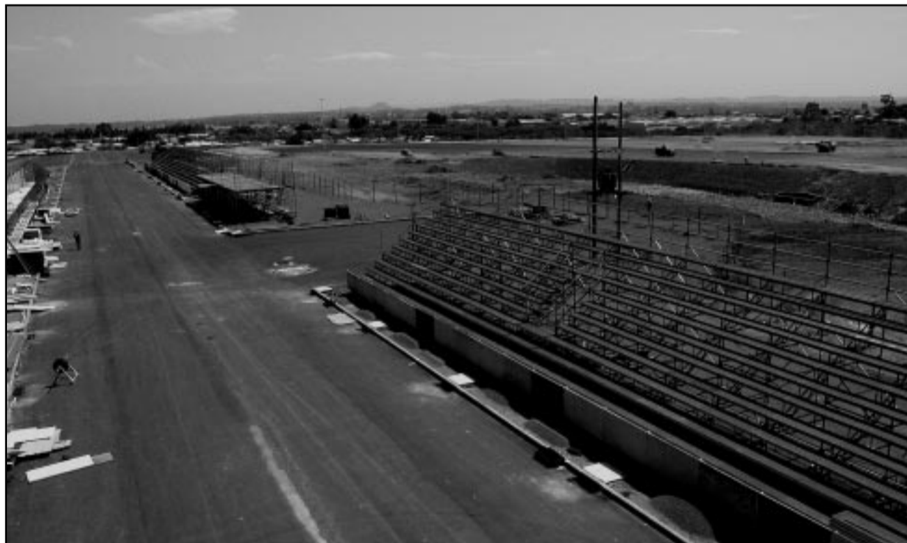
Ainda em construção, a pista já vai abrigar o desfile deste ano
