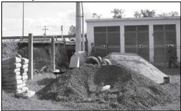
DEP investe R$1,6 milhão para ampliar capacidade de casas de bombas
