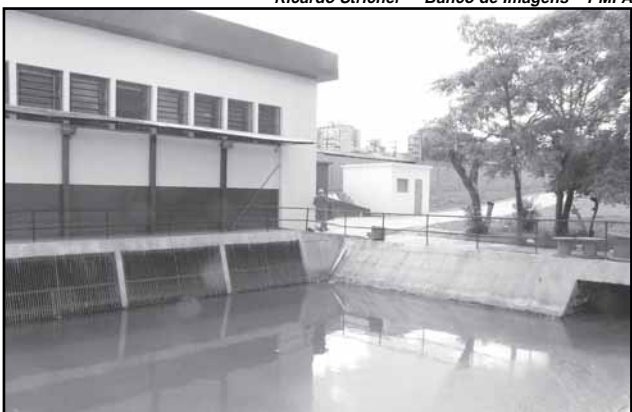
Qualificação das Casas de Bombas do DEP está em fase de licitação.
