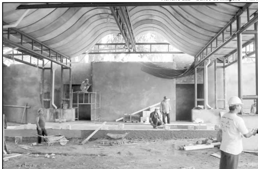
Estrutura dos terminais das praças Rui Barbosa e Parobé foi aproveitada na construção
