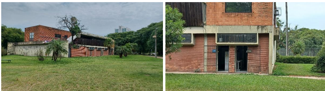
Figura 3.4.2.6.3. Algumas Edificações Estavam Inóspitas - Segundo Banheiro do Lado Norte
