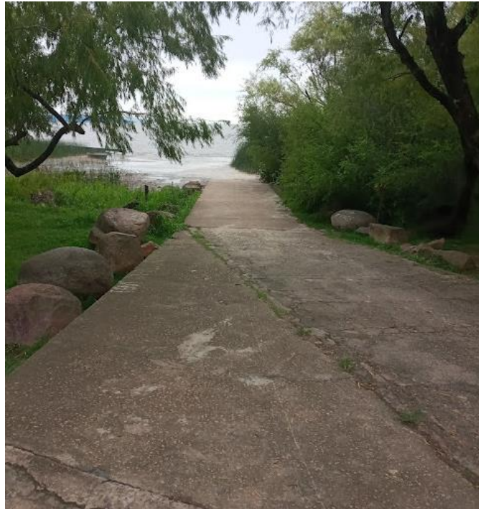
Figura 3.5.3.8.7. Rampa de Acesso para Embarcações
