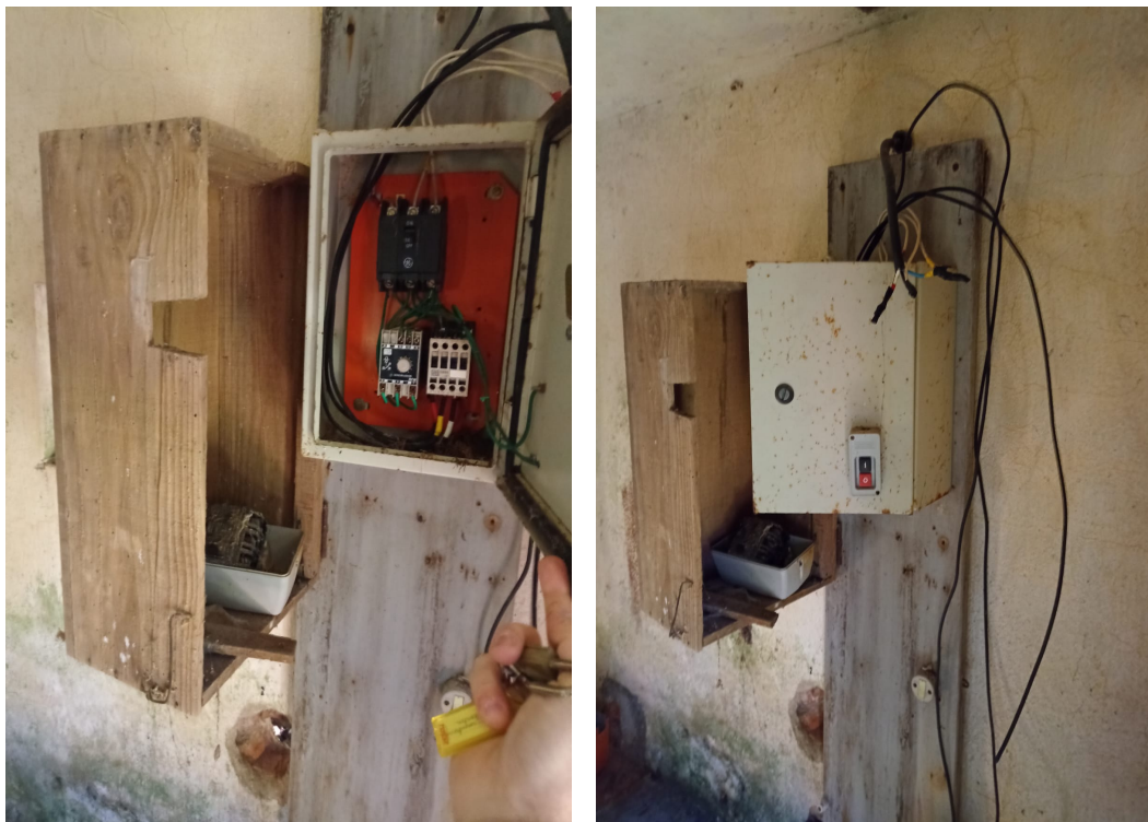
Quadro de Comando estragado
