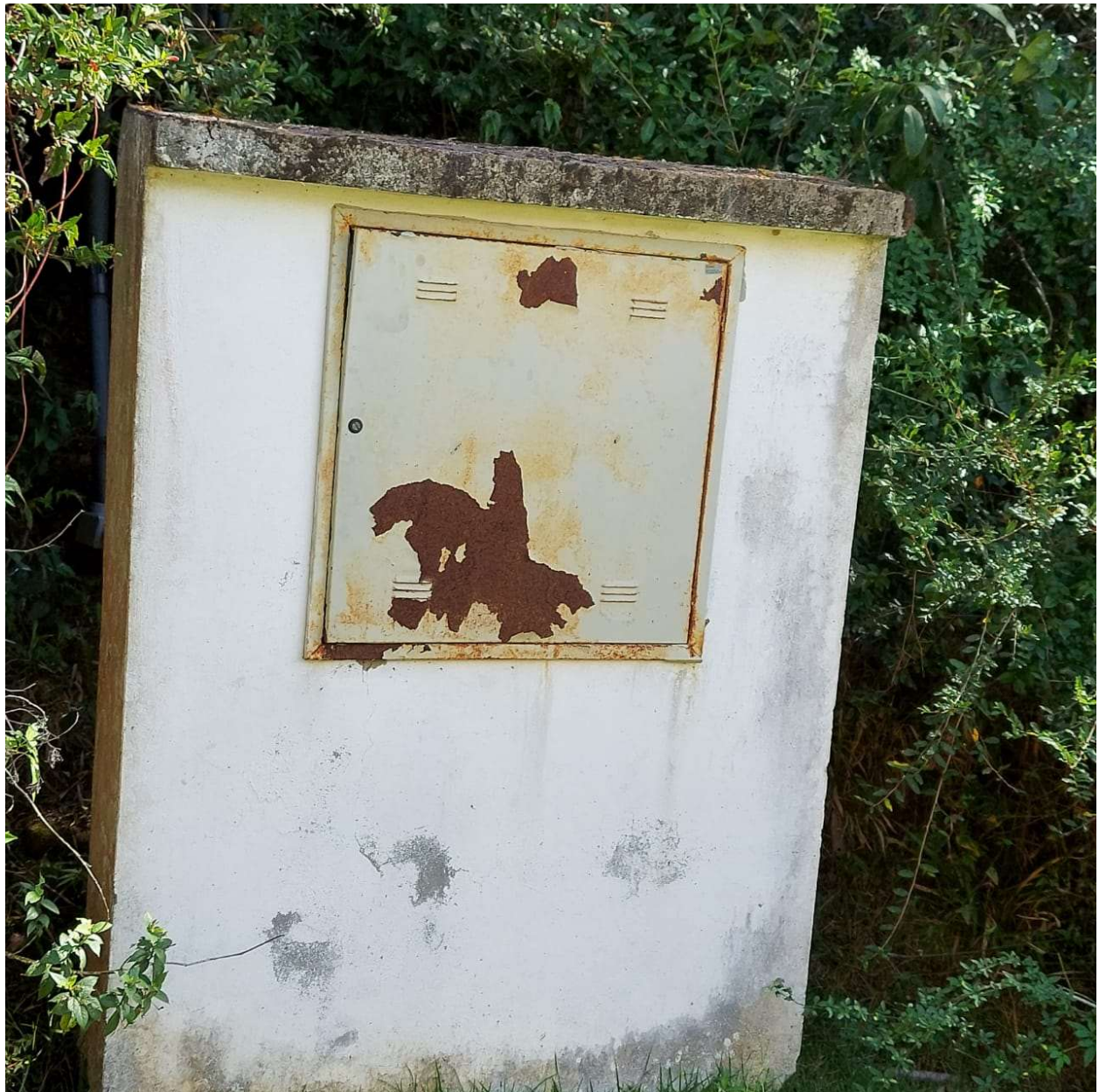
Imagem: Painel antigo subdimensionado
