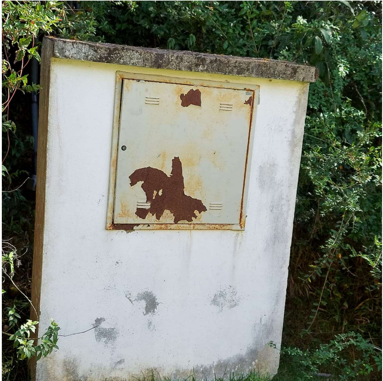
Imagem: Pannel antigo subdimensionado
