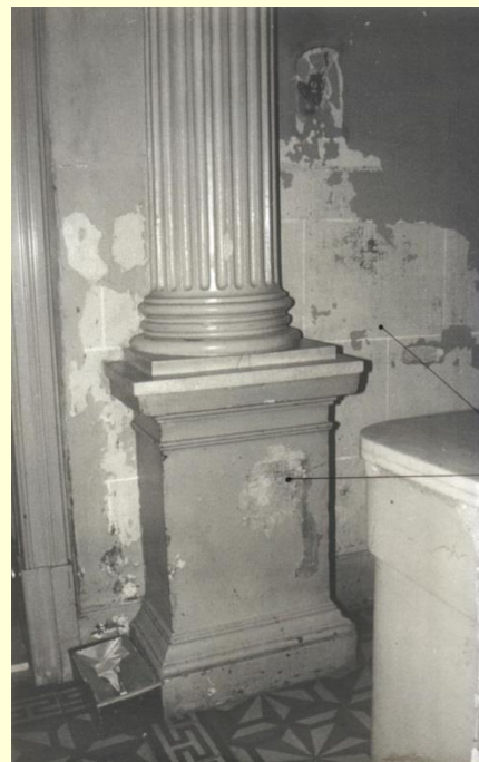
Descolamento da pintura
