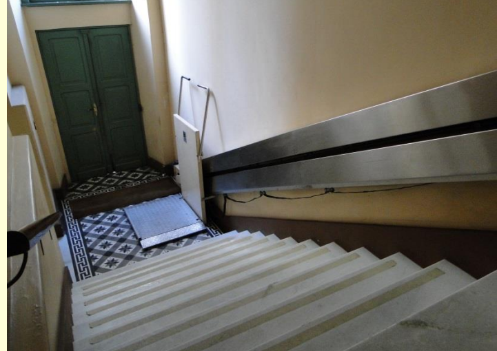
Acesso e plataforma elevatória para PPD's
