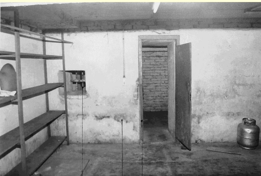
Antiga Cadeia utilizada como depósito. Umidade ascendente, botijão de gás.
