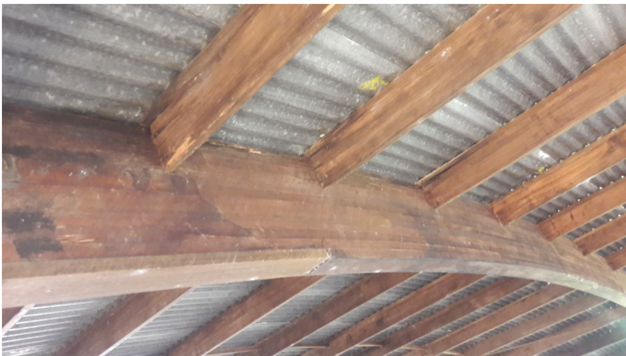
Foto 8 – Detalhe de um trecho do arco de madeira e terças com sinais de ataques por cupins e umidade.
