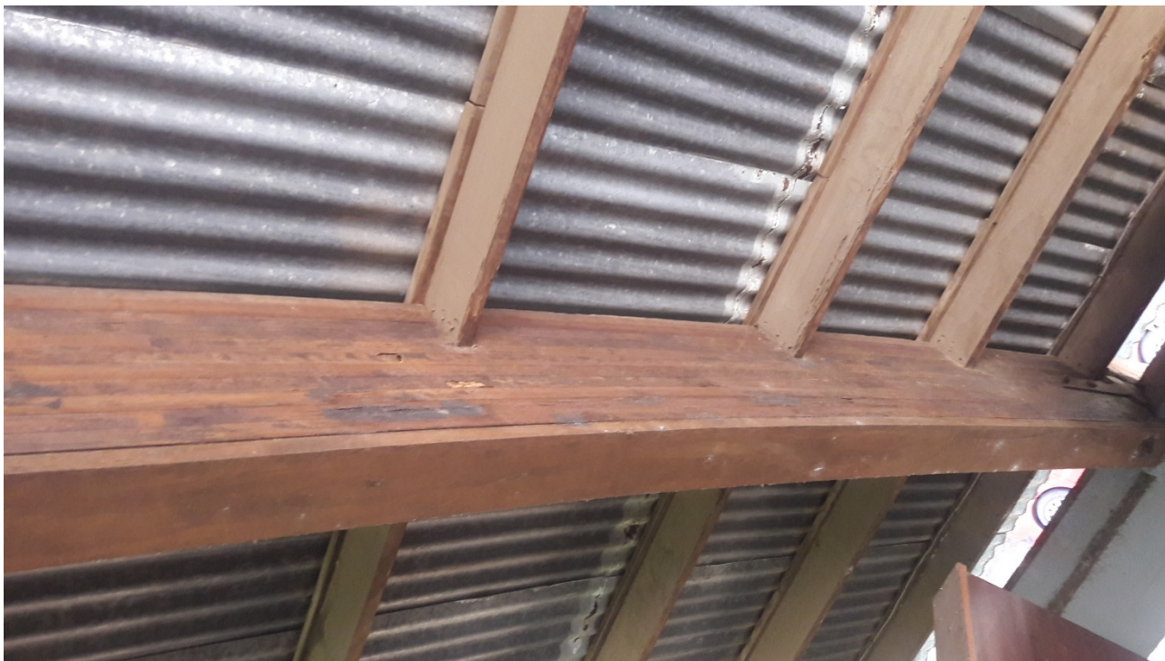
Foto 7 – Detalhe de um trecho do arco de madeira com sinais de ataques por cupins e umidade.
