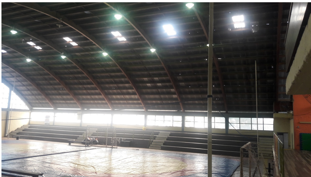
Foto 11 – Vista geral do interior do Ginásio Lupi Martins, destacando a estrutura de cobertura e arquibancadas.
