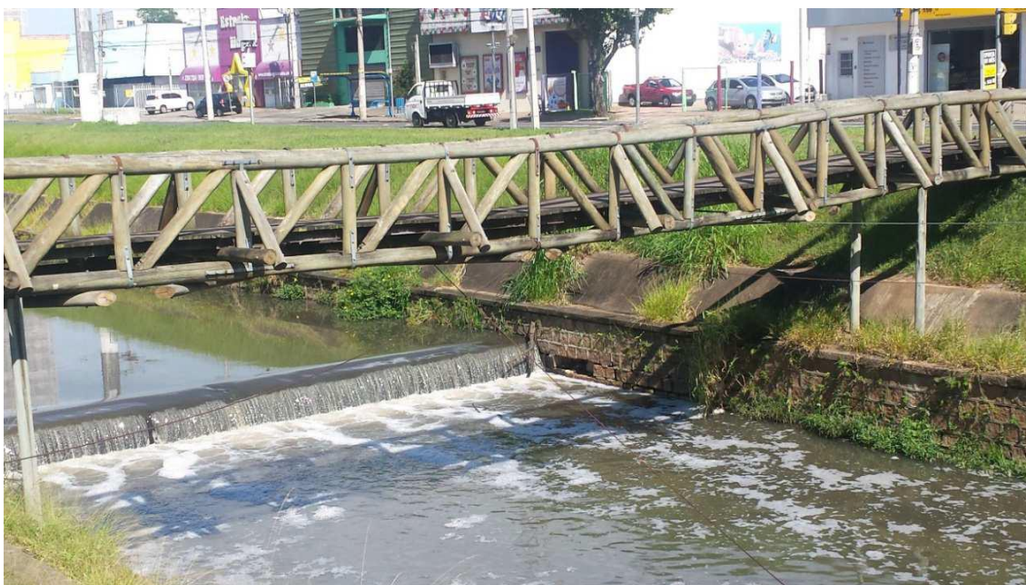
Foto 04 – Passarela de madeira, antiga, na Av.Ipiranga nº 8165 ( travessia sobre o Arroio Dilúvio, frente à CEEE ). Essa passarela não existe mais, foi demolida e removida tendo em vista as grandes deformações que a estrutura de madeira apresentava
