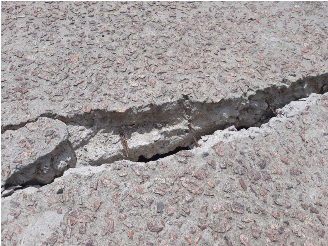
Foto 03 – Passarela da Rua Arvoredo, 160. Estado de ruptura no meio do vão da passarela ( junto ao apoio central da passarela ).
