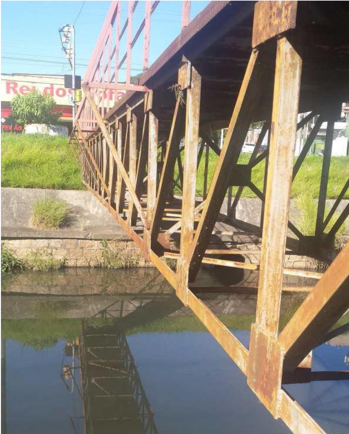
Foto 05 – Passarela metálica sobre o Arroio Dilúvio na Av. Ipiranga x Rua Albion ( estrutura toda oxidada com partes corroídas em sua plataforma ).
