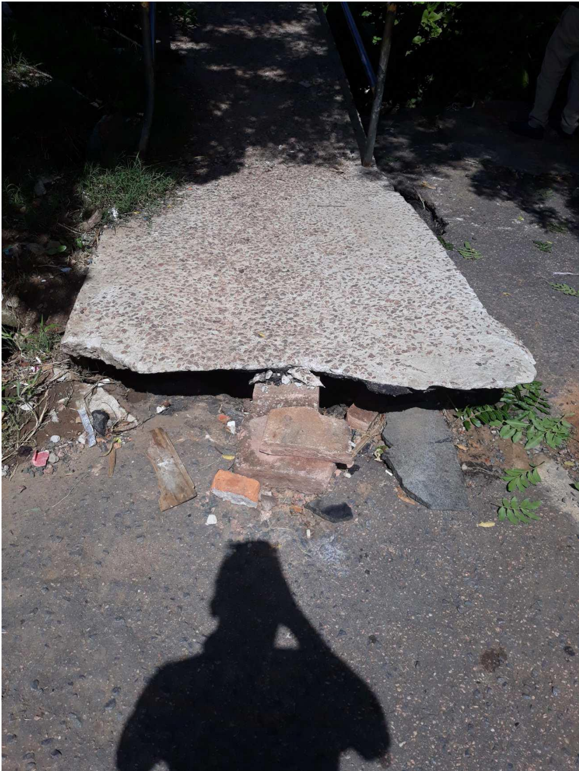
Foto 02- Passarela da Rua Arvoredo, 160. Apoio em uma das cabeceiras já comprometido.
