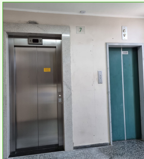
Elevadores do Bloco C HMIPV
