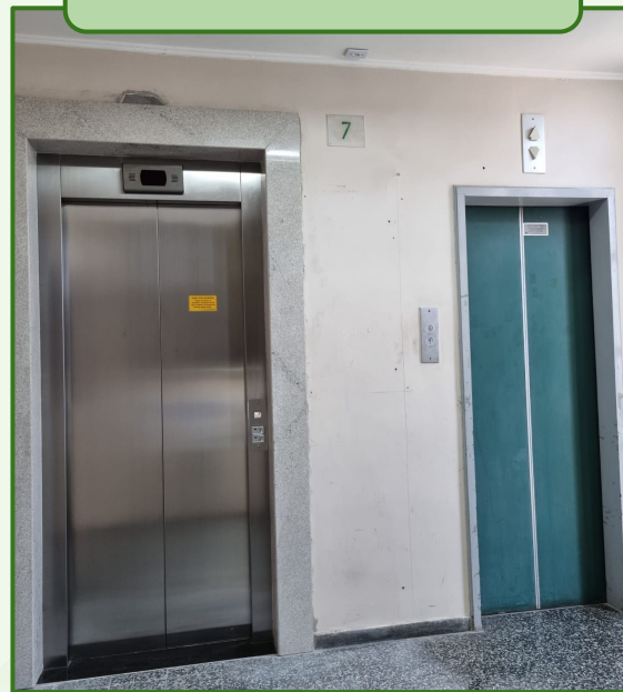
Elevador do Bloco C
